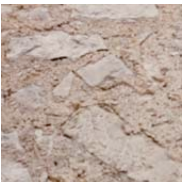
35 - Le mortier des joints ne fait pas le tour de chaque pierre.
