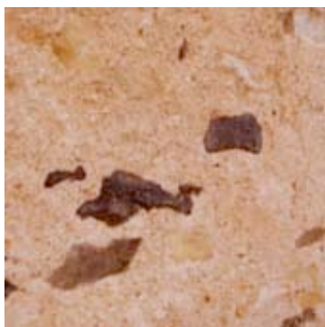
36 - Quand les joints sont bien réalisés ils s'imposent par la qualité de leur matière et laissent aux pierres leur juste place. Elles affleurent sans se détacher une à une.
