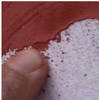
FAIBLE ÉPAISSEUR de la couche de stuc.
